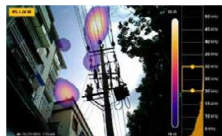
10kv 线路杆塔线夹和绝缘子放电
