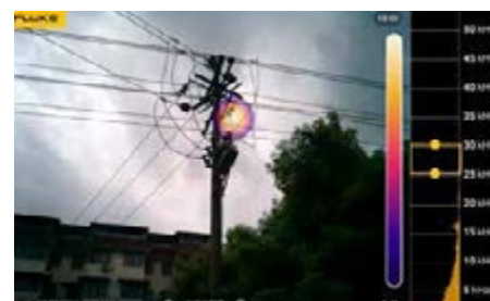
10kv 线路杆塔绝缘子放电
