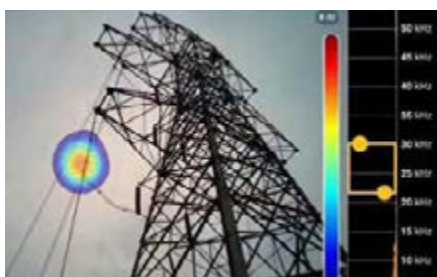
220kv 输电线路线夹放电
