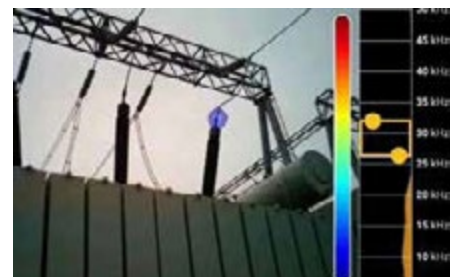
变压器出现接头放电
